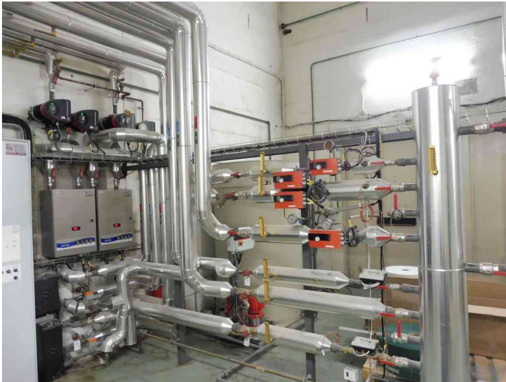
Echangeurs - Récupération des calories
